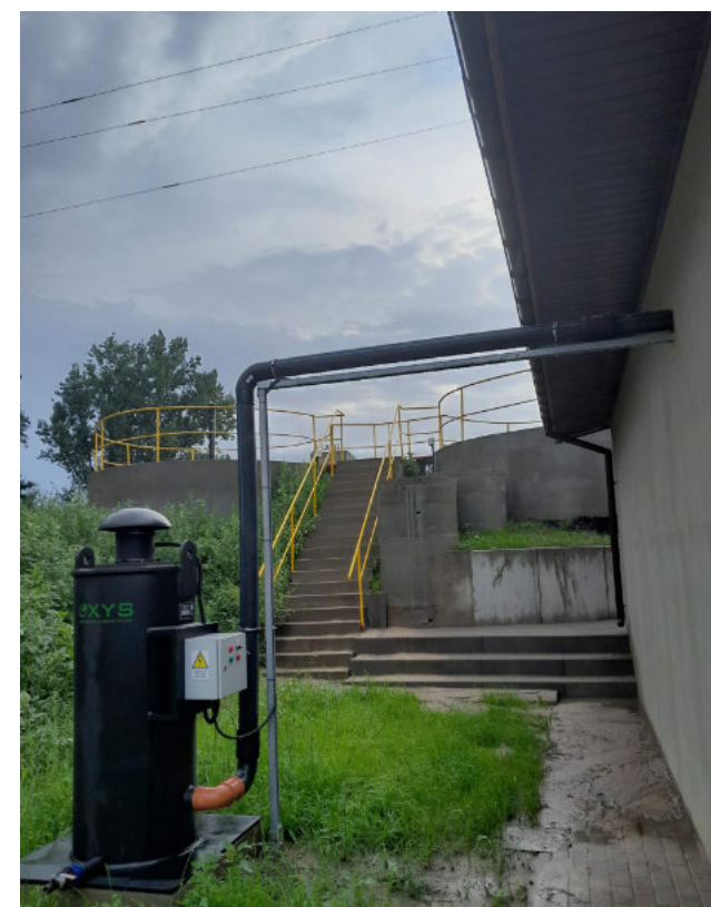
Oczyszczalnia ścieków w gminie Chocień
